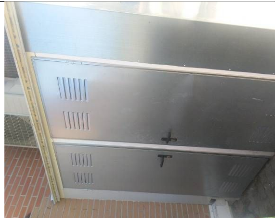
Armario de gas
